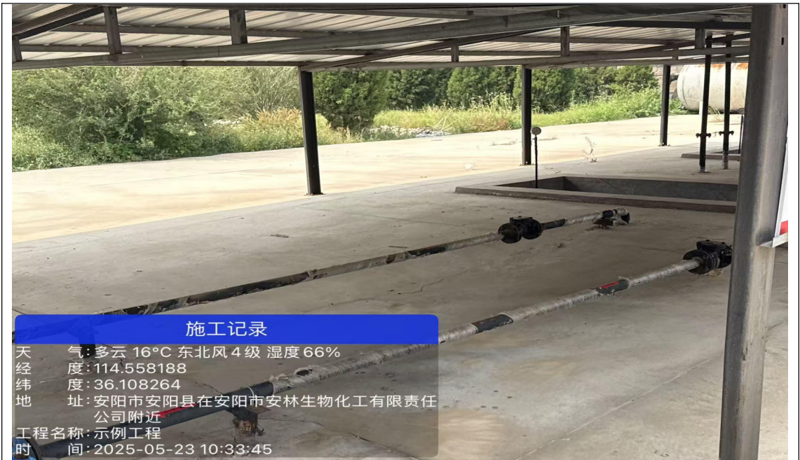
二甲苯地下埋罐
